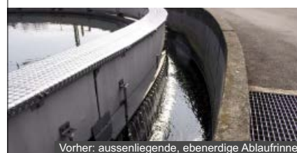
Vorher: aussenliegende, ebenerdige Ablaufrinne
