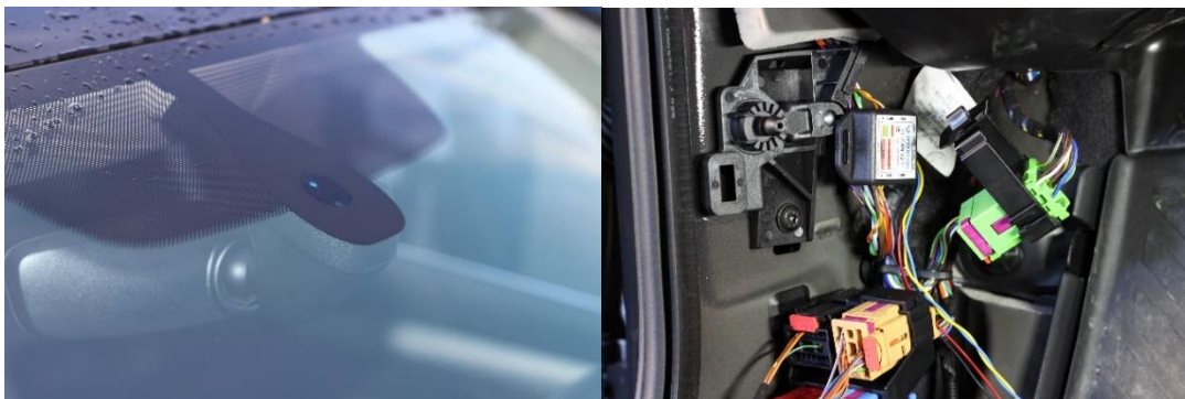
Abb. 4. Fotos von der Einbauphase: verbauter Regensensor hinter der Windschutzscheibe, Verkabelung für Datenabgriff und Datenübertragung (Quelle: EGLV)
