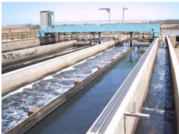
Abbildung: Foto Kläranlage Algerien, Prof KU Rudolph
