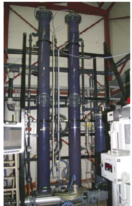
Versuchsanlage zur Ozonung
