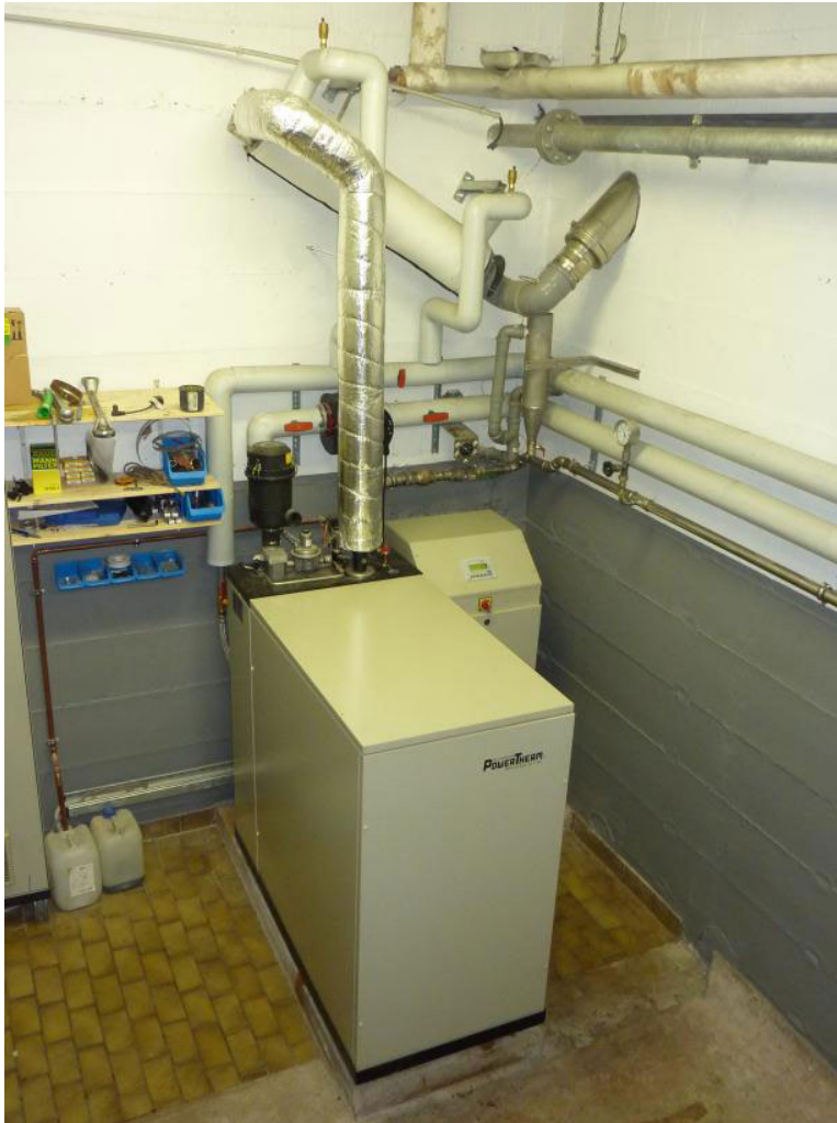
Bild 27: Gasmotor mit Brennwert-Wärmetauscher
