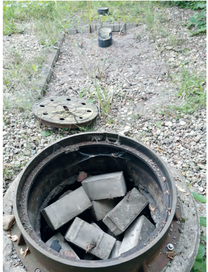
Abb. 5: Rigolen-Revisionsschacht am Weidigtbach nach der Zerstörung
