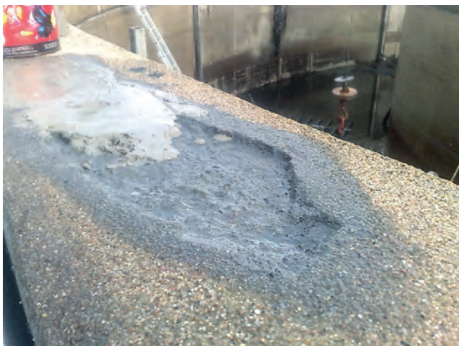
Abb. 12: Auf dieser Laufbahn hat Väterchen Frost ganze Arbeit geleistet.
