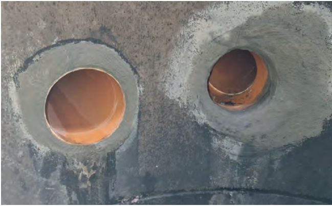
Abb. 3: Wiederhergestellte Anschlüsse im noch verrußten Schacht
