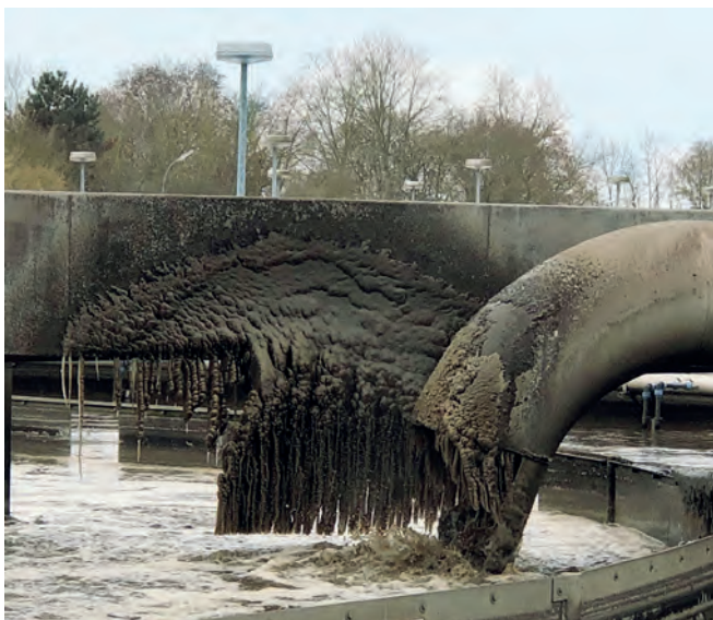
Abb. 8: Gefrorenes Schlammwasser am Auslauf der Rücklaufschlammleitung. Das sind keine einfachen Wartungsarbeiten.
