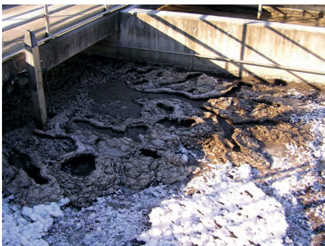
Abb. 9: Frostbeulen im Belebungsbecken
