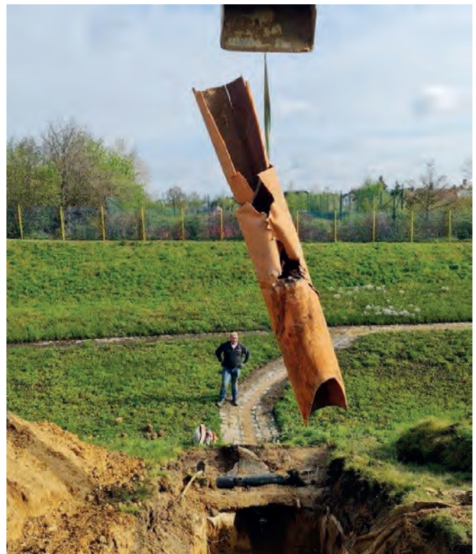
Abb. 2: Das verformte Auslassrohr am Haken
