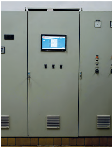
Abb. 2: Panel-PC im Schaltschrank integriert
