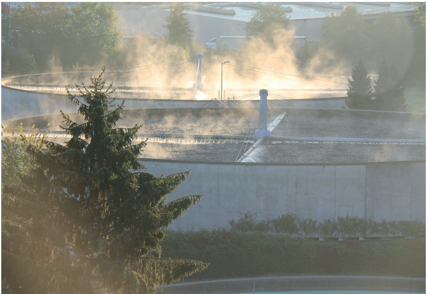
Kläranlage Böblingen-Sindelfingen, Baden-Württemberg
