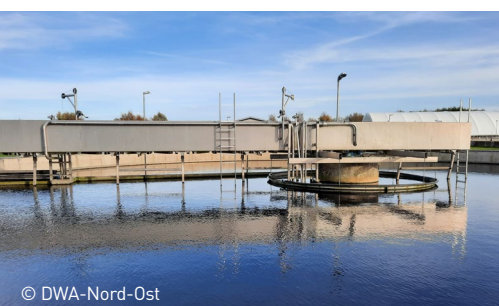
Kläranlage Greifswald-Ladebow, Mecklenburg-Vorpommern
